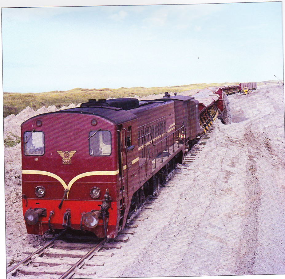
Het storten van het zand in Ter Heijde vond plaats in het kader van het Deltaplan. NS-loc 2231 met de kiepwagens tijdens het lossen. Stichting Rail Publicaties
