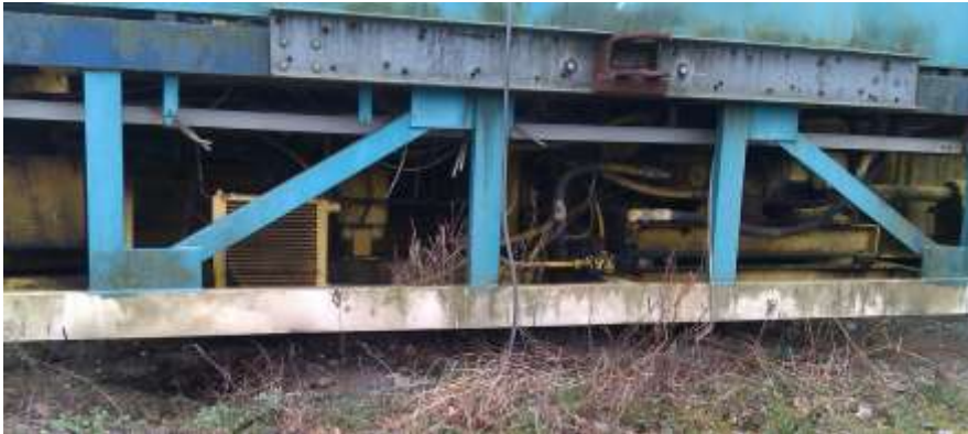
Electrisch-hydraulisch aggregaat en rijaandrijving bij brug 1 (foto GJ)
