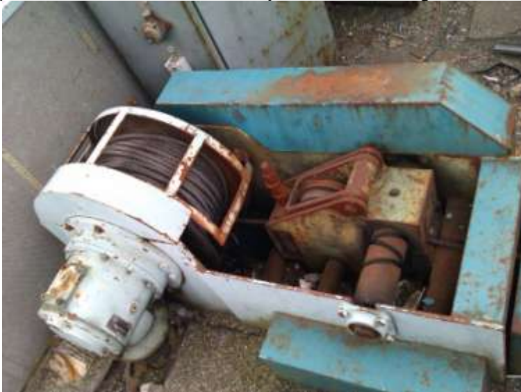
Hydraulisch aangedreven lier met draadspoolinrichting op Brug 1 (foto GJ)
