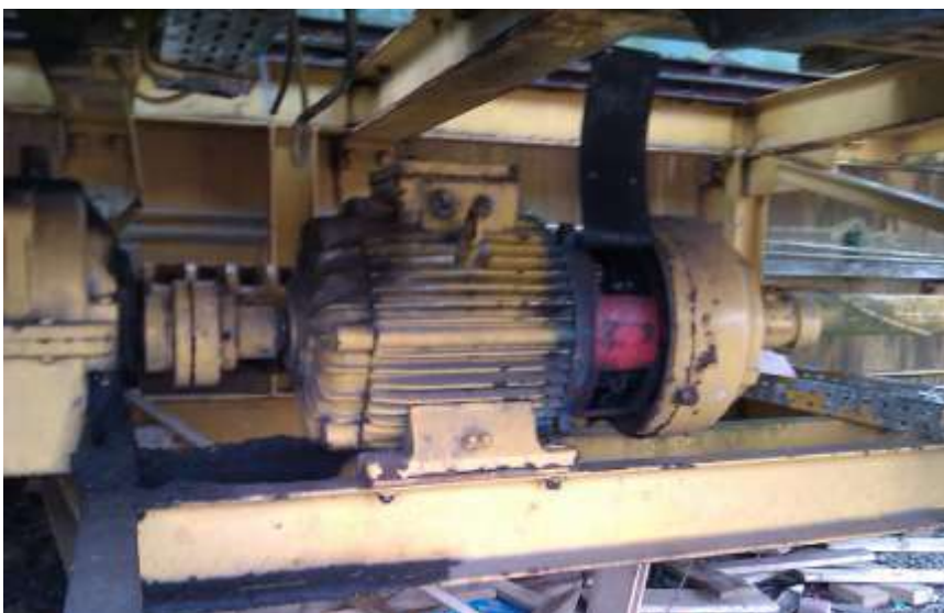
Rijaandrijving met gelijkstroomshunt motor van brug 2 (foto GJ)
