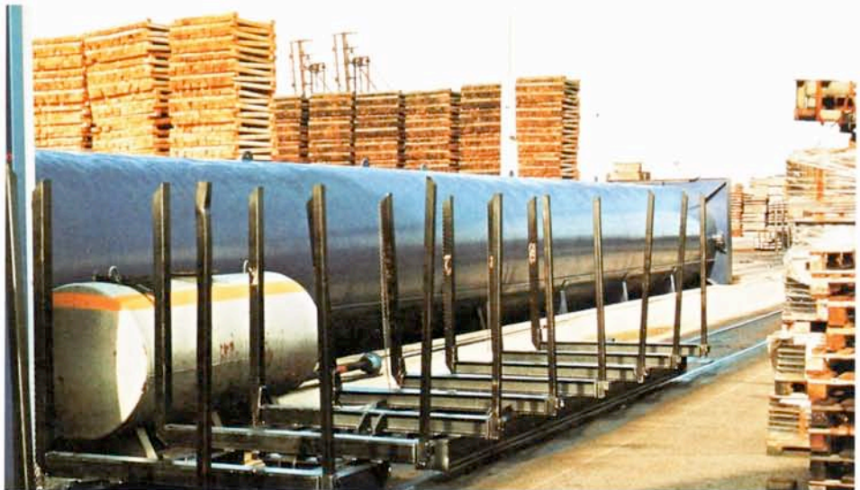
De nieuwe koelketel met omloopspoor en enkele lorries voor het houttransport door de ketels; 10 juli 1999.
