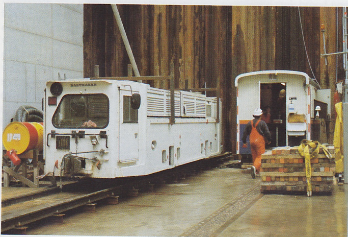
Loc Balthasar in de „startschacht” van de Botletunnel. Hoogvliet, 24 september 1999. Foto: Gerard de Graaf.
